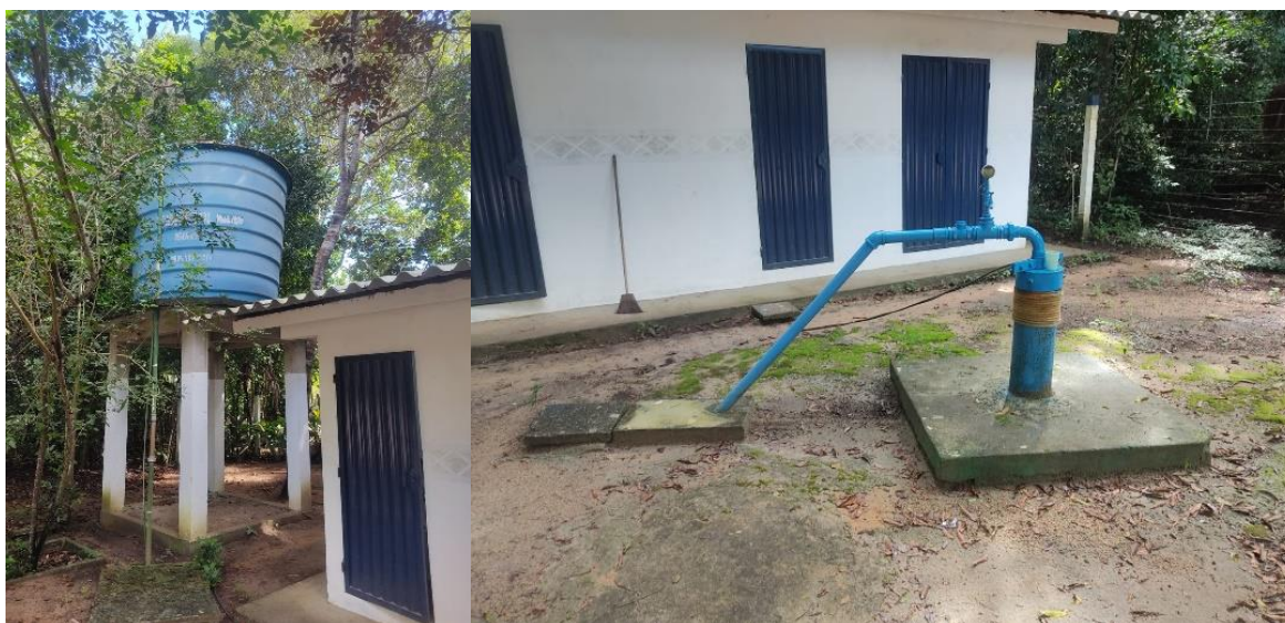
Figura 5 - Sistema de bombeamento de água de poço na Aldeia Pataxó localizados na Reserva da Jaqueira (Porto Seguro – BA).
